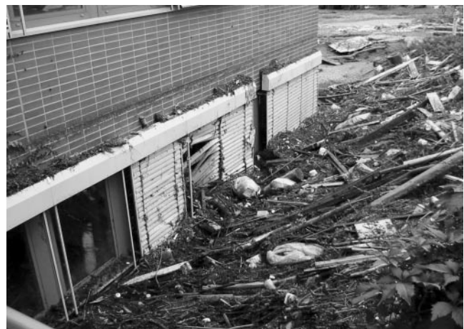
Bild 2: Schäden an der Außenanlage nach dem Hochwasser (KH Freital)
